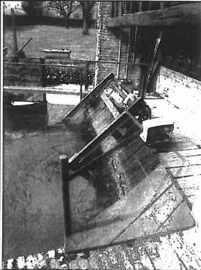
Grille, dégrilleur et exutoire par 1 ère vanne ouverte
